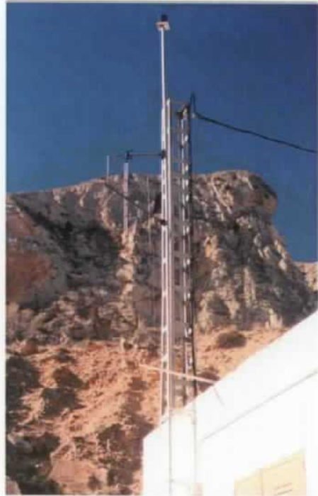
Telemando en el Pozo de Pineta
